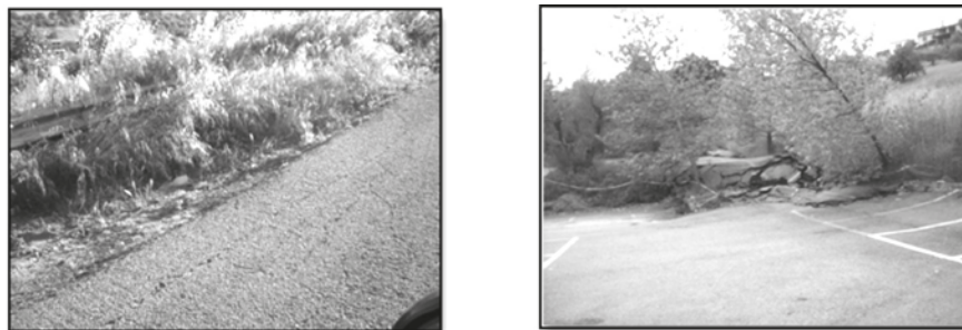
Foto 3. Nicchia di distacco sulla strada comunale (a), arricciatura del piede nel parcheggio del dipartimento (b)
