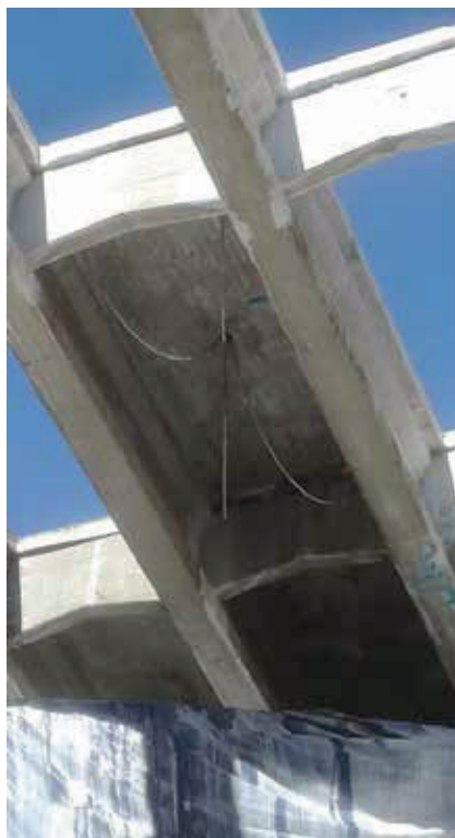
Metodologia di imbracaggio del concio di soletta con catene metalliche specifiche per il sollevamento.
