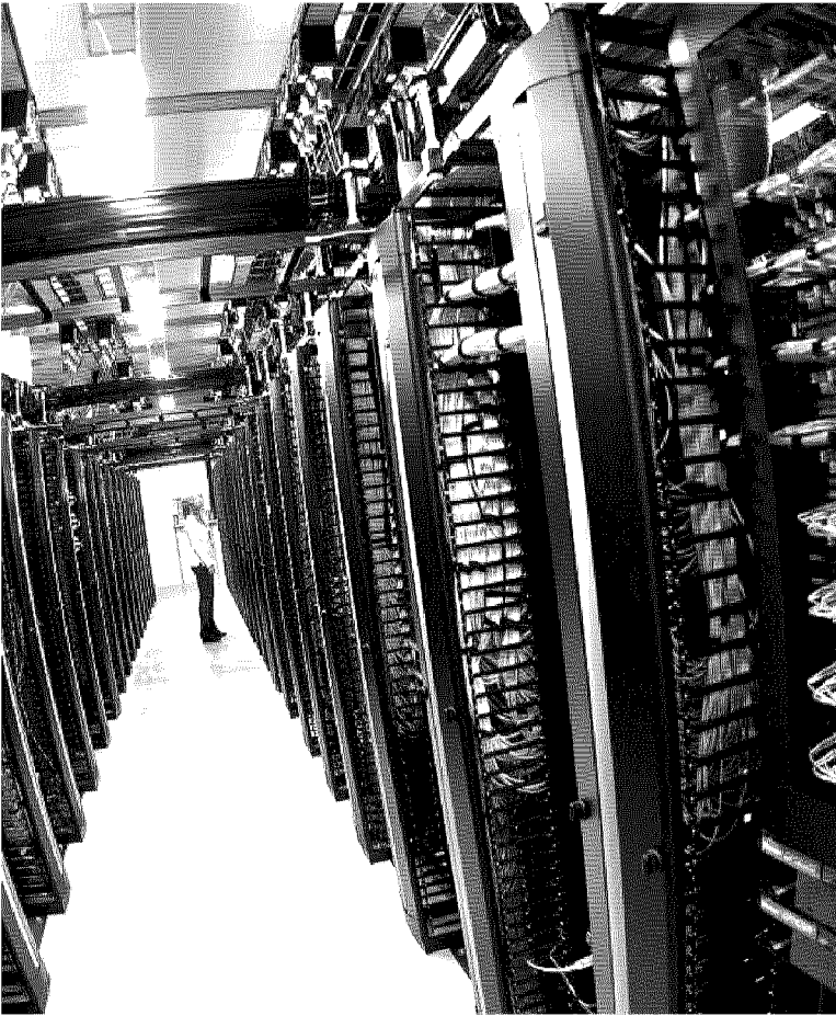
Data center. L'investimento servirà per incrementare l'offerta per imprese, start up, enti pubblici e organizzazioni impegnate sull'intelligenza artificiale
