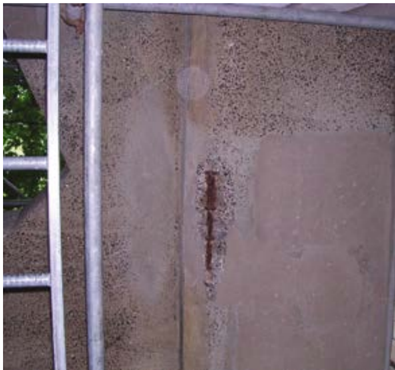
Figura 1. La zona del ripristino (rappezzo)
